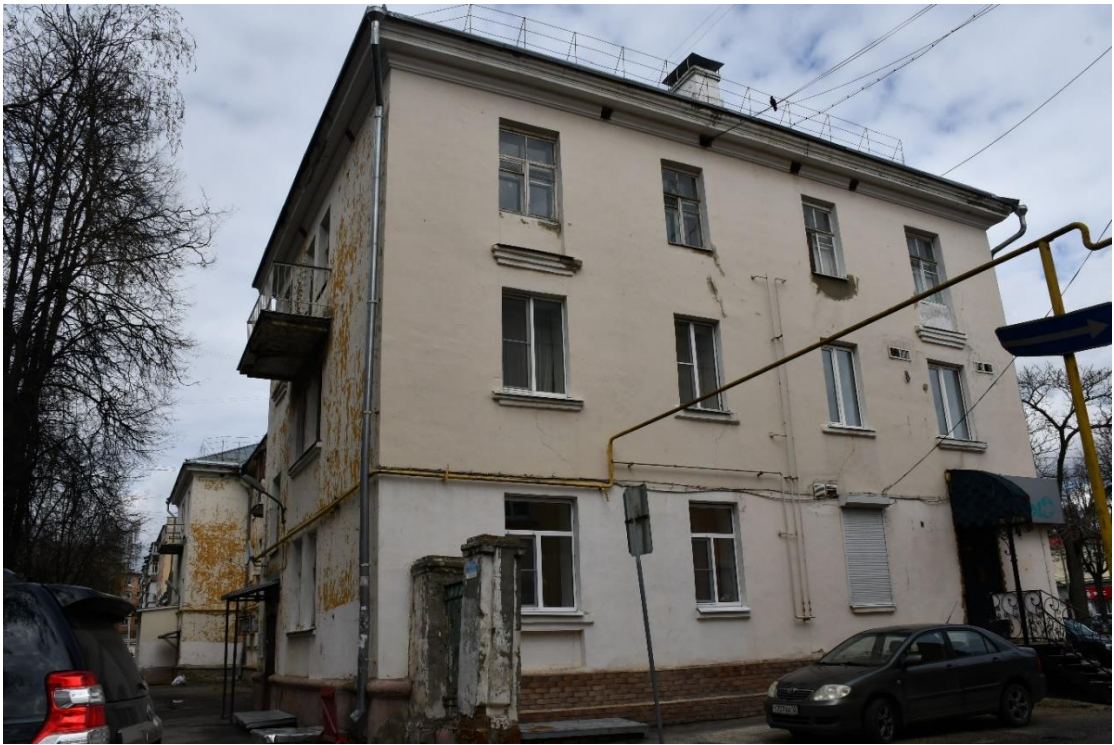
Фото 3. ОКН «Дом жилой, 1960 г.». Общий вид объекта с юга. Отслоение штукатурного и окрасочного слоев, наличие сквозных механических отверстий на юго-восточном фасаде – приточные, выполнены без согласования Минкультуры Республики Марий Эл, архитектурные элементы имеют сколы.
