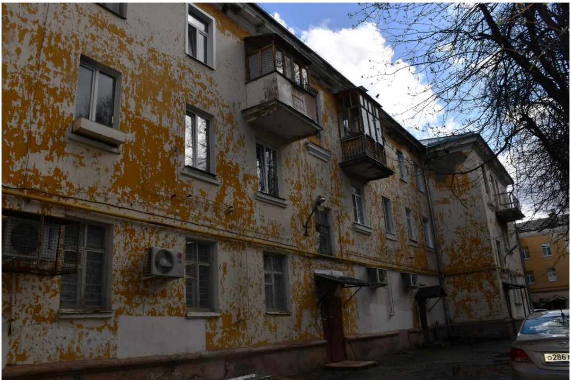
Фото 4. ОКН «Дом жилой, 1960 г.». Юго-западный фасад. Отслоение штукатурного и окрасочного слоев, наличие сквозных механических отверстий на северо-западном и юго-западном фасадах для установки кондиционеров, выполненные без согласования Минкультуры Республики Марий Эл, балконы в неудовлетворительном состоянии, заполнения оконных проемов частично заменены на пластиковые.
