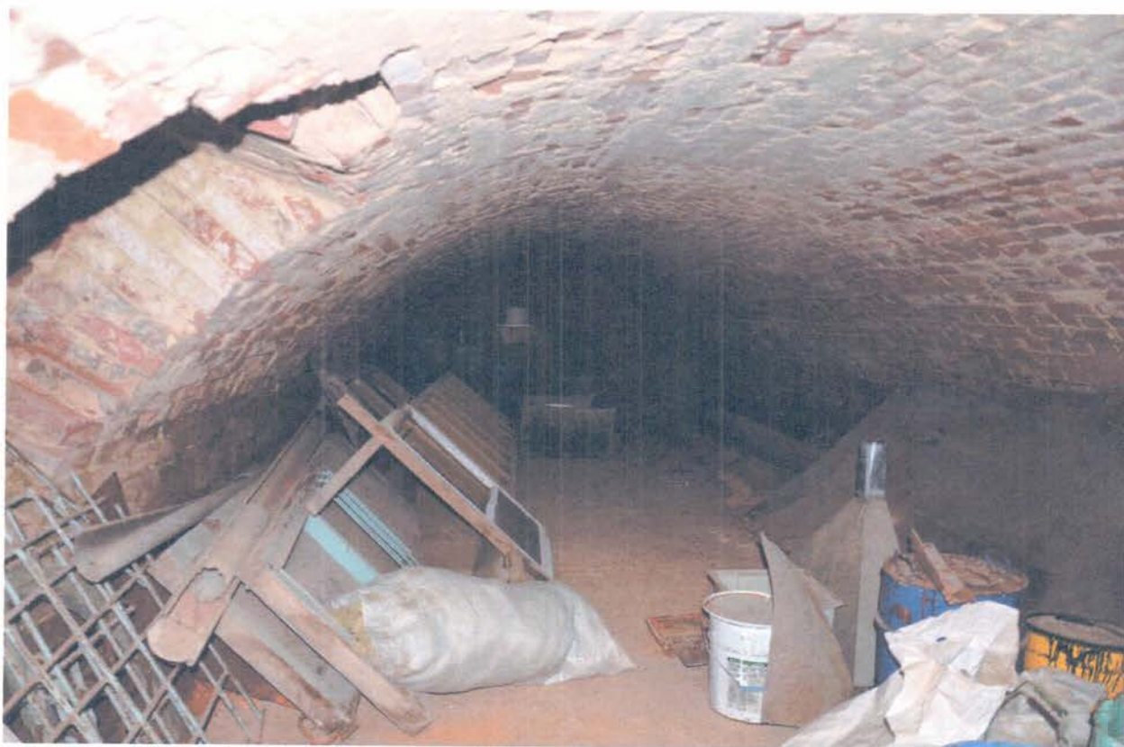
Фото 30. ОКН «Церковь святителя Николая Чудотворца». Фрагмент интерьера (подвал). Увлажнение и биопоражение (мох) свода подвала, на локальных участках незначительные вывалы кладки.
