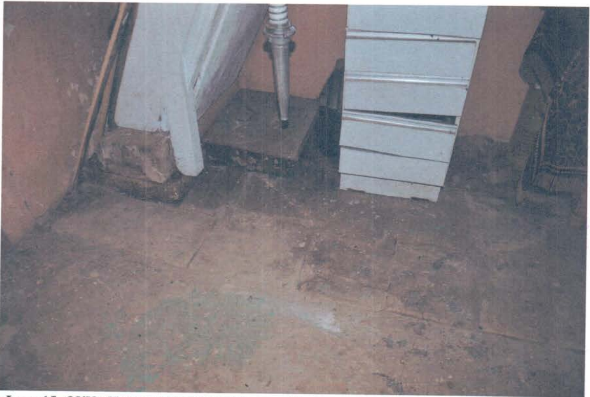
Фото 15. ОКН «Церковь святителя Николая Чудотворца». Фрагмент интерьера (притвор). Полы каменные (предположительно из известковых плит), состояние неудовлетворительное, растрескивание плит, сколы, небольшие утраты.
