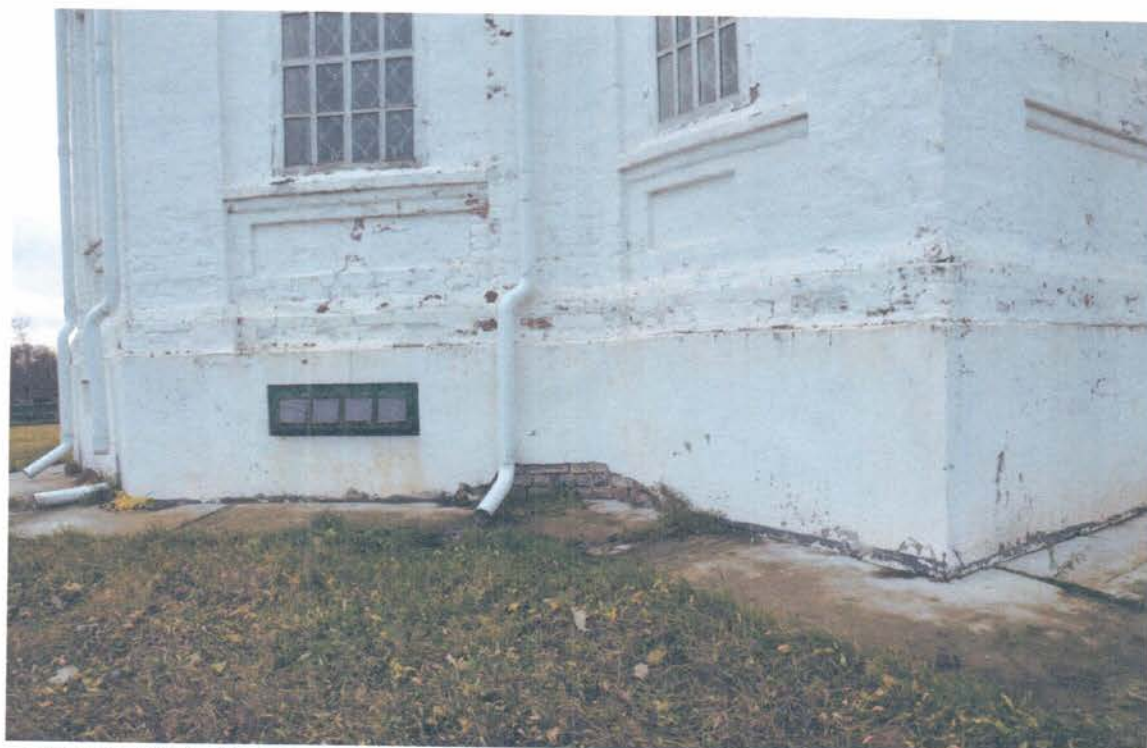
Фото 6. ОКН «Церковь святителя Николая Чудотворца». Фрагмент восточного фасада. Множественные трещины в штукатурном слое, на локальных участках отслоение штукатурного слоя, увлажнение и биологическое повреждение (мох, лишайник) штукатурного слоя и кладки цоколя в местах отсутствия штукатурного слоя, отмостка имеет трещины, биологическое повреждение (мох, прорастание самосеивной травы через конструкцию отмостки).
