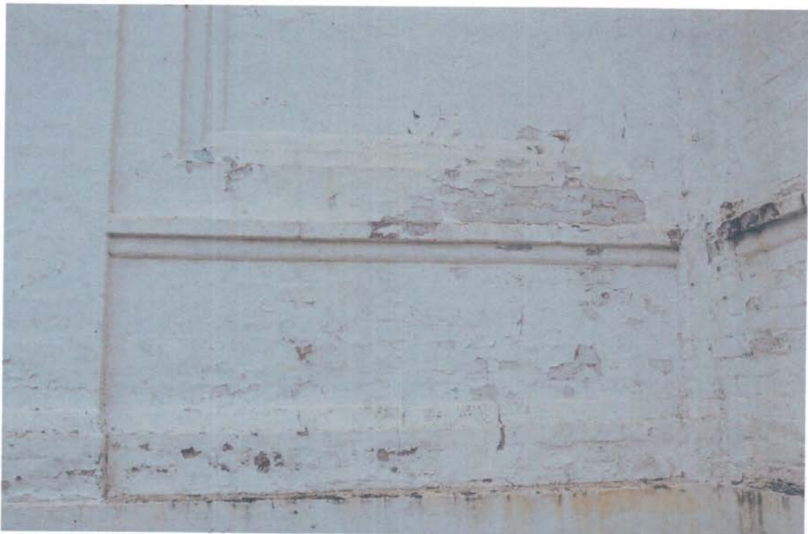
Фото 10. ОКН «Церковь святителя Николая Чудотворца». Фрагмент северного фасада. Повреждение обмазки в результате атмосферных воздействий.
