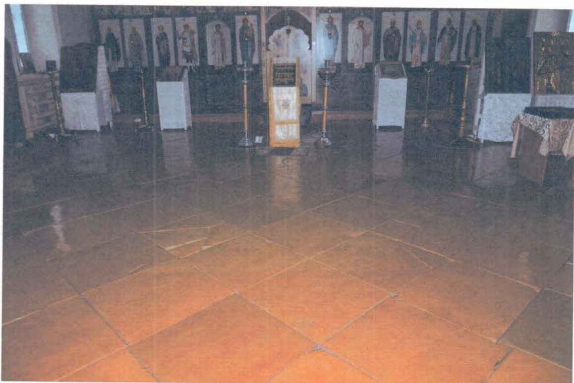
Фото 18. ОКН «Церковь святителя Николая Чудотворца». Фрагмент интерьера (трапезная). Полы каменные (предположительно из известковых плит), состояние неудовлетворительное, растрескивание плит, сколы, небольшие утраты.
