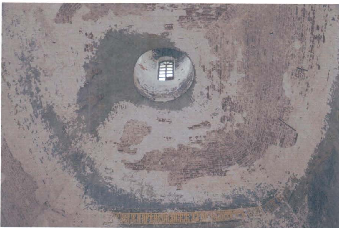
Фото 29. ОКН «Церковь святителя Николая Чудотворца». Фрагмент интерьера (четверик). Сохранились фрагменты росписей сводов и стен, состояние неудовлетворительное, наличие трещин в штукатурном слое, утраты штукатурного слоя, разрушения красочного слоя, красочный слой шелушится, наблюдаются вспучивания и отставания красочного слоя от основы, утраты штукатурного и окрасочного слоев.
