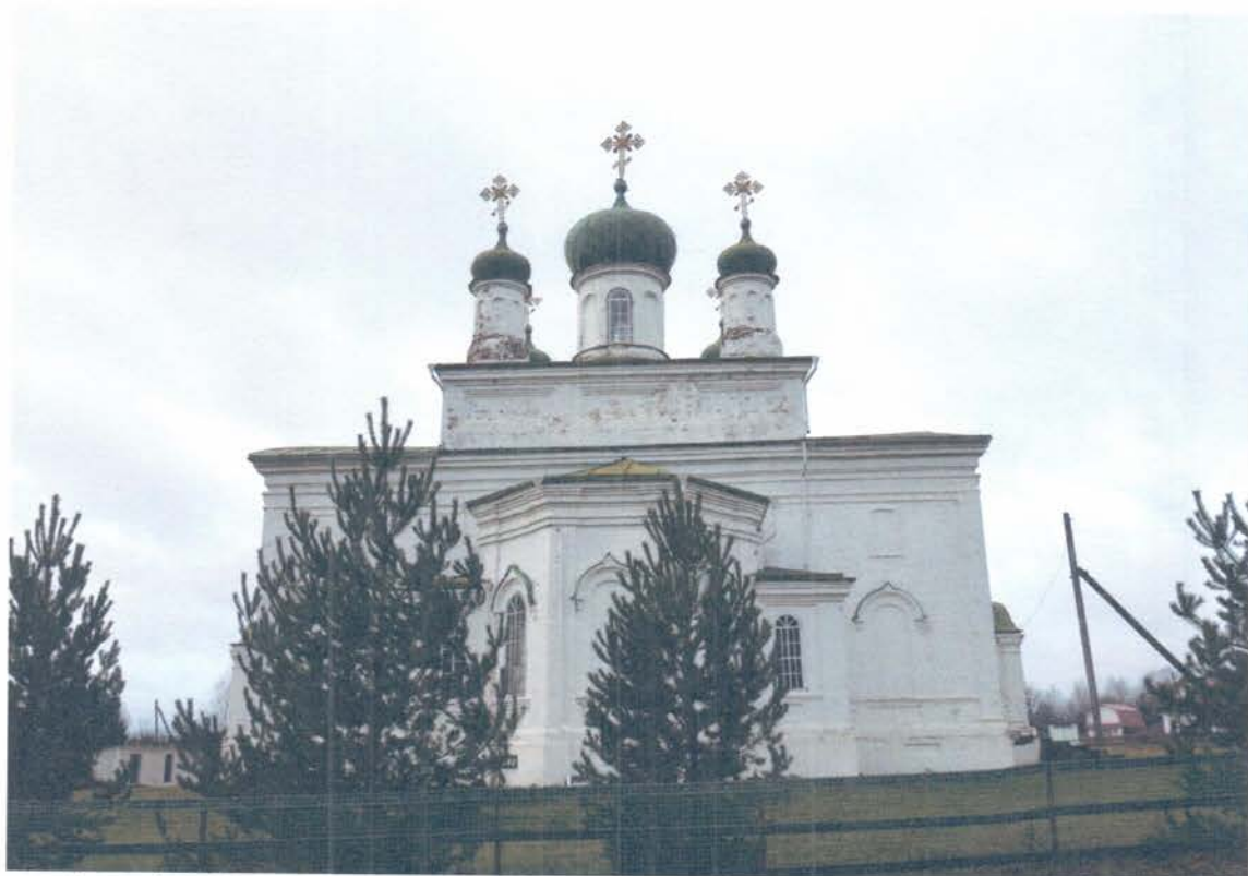
Фото 4. ОКН «Церковь святителя Николая Чудотворца». Вид на объект с востока. Повреждение обмазки фасадов в результате атмосферных воздействий, наличие ржавчины на поверхности кровли, фиксируется ослабление части оттяжек крестов на главках четверика, отклонение части крестов от вертикали.
