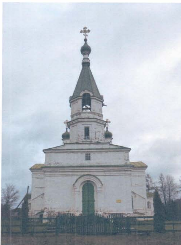
Фото 3. ОКН «Церковь святителя Николая Чудотворца». Вид на объект с запада. Повреждение обмазки фасадов в результате атмосферных воздействий, наличие ржавчины на поверхности кровли, отсутствуют водосточные трубы.
