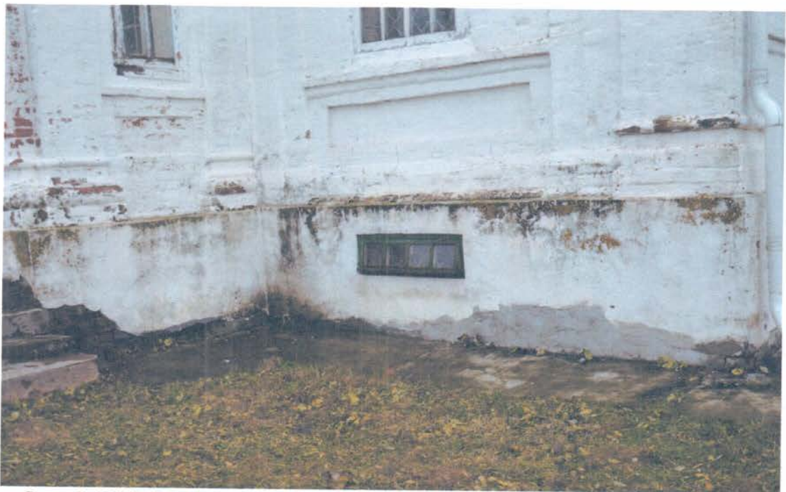
Фото 8. ОКН «Церковь святителя Николая Чудотворца». Фрагмент северного фасада. Множественные трещины в штукатурном слое, на локальных участках отслоение штукатурного слоя, увлажнение и биологическое повреждение (мох, лишайник) штукатурного слоя и кладки цоколя в местах отсутствия штукатурного слоя, на локальных участках деструкция кирпичной кладки, отмостка имеет трещины, биологическое повреждение (мох, прорастание самосеивной травы через конструкцию отмостки).
