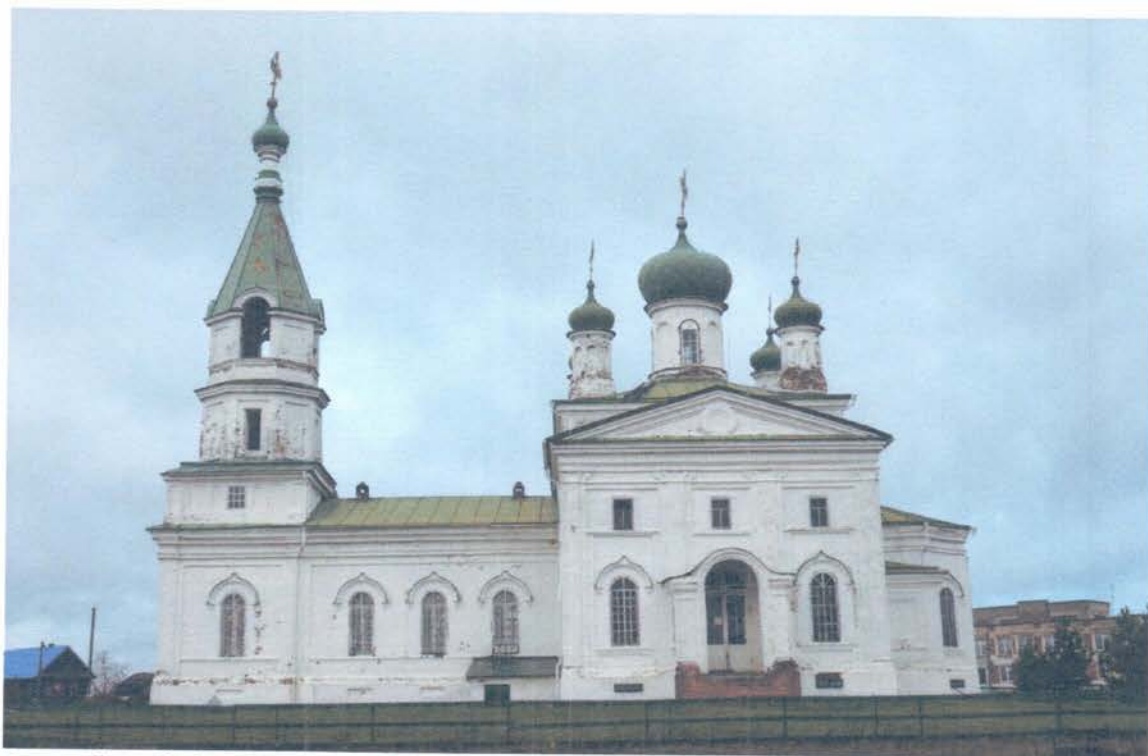
Фото 2. ОКН «Церковь святителя Николая Чудотворца». Вид на объект с юга. Повреждение обмазки в результате атмосферных воздействий, наличие ржавчины на поверхности кровли, частично отсутствуют звенья водосточных труб, водосборные воронки и отметы, ступени паперти утрачены.
