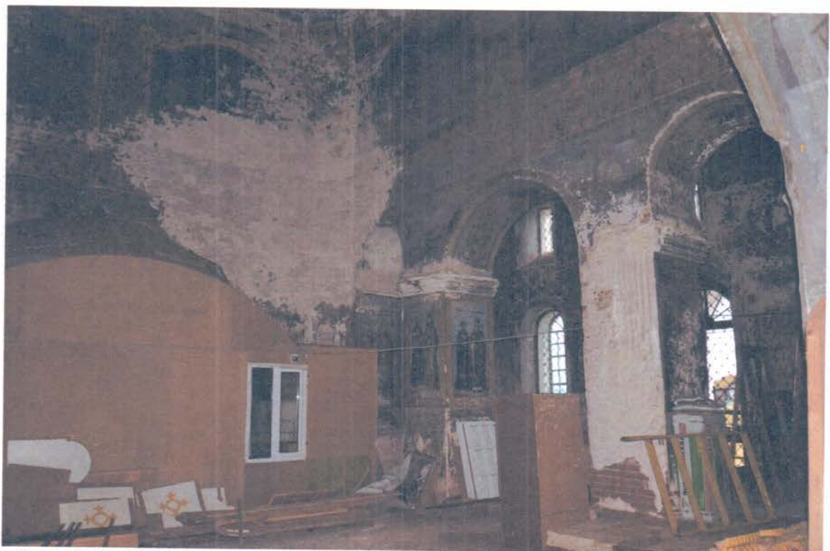
Фото 24. ОКН «Церковь святителя Николая Чудотворца». Фрагмент интерьера (четверик). Наличие общих загрязнений поверхностей стен, копоти, сохранились фрагменты росписей сводов и стен, состояние неудовлетворительное, наличие трещин в штукатурном слое, утраты штукатурного слоя, разрушения красочного слоя, красочный слой шелушится, наблюдаются вспучивания и отставания красочного слоя от основы, утраты штукатурного и окрасочного слоев.
