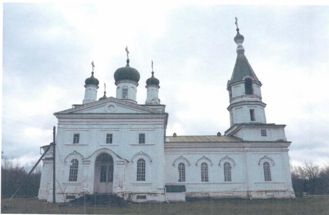
Фото 1. ОКН «Церковь святителя Николая Чудотворца». Вид на объект с севера. Повреждение обмазки в результате атмосферных воздействий, наличие ржавчины на поверхности кровли, частично отсутствуют звенья водосточных труб, водосборные воронки и отметы.
