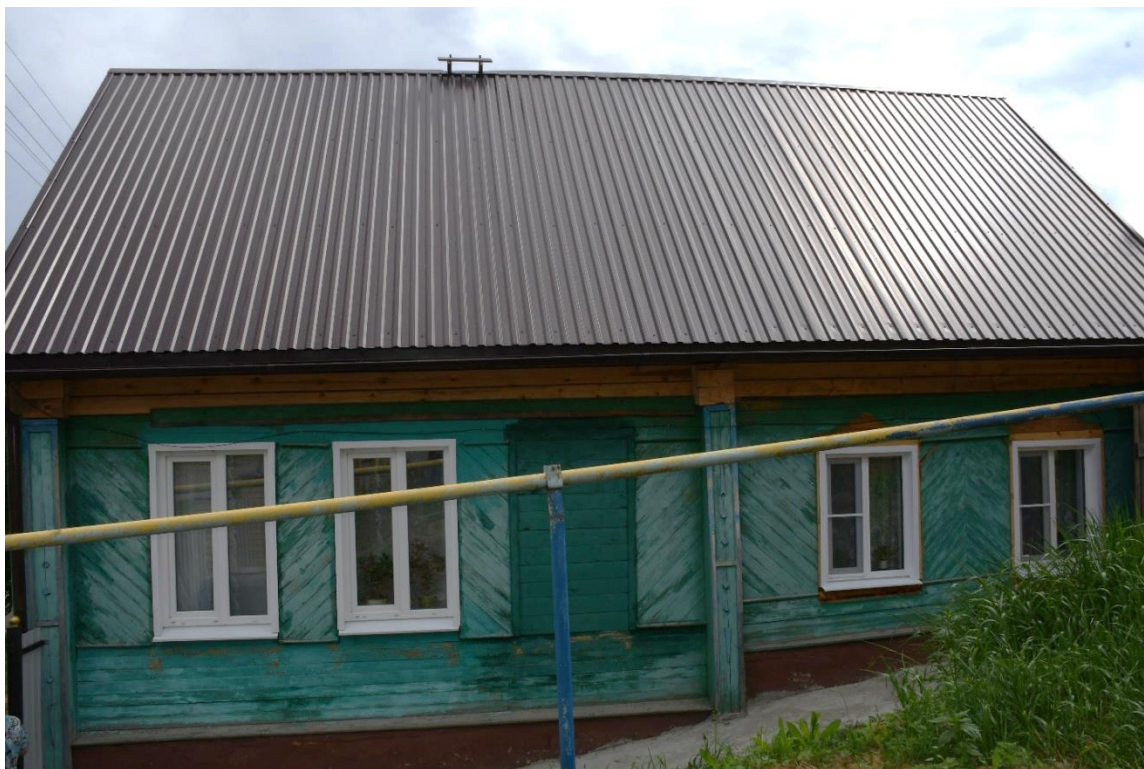
Фото 5. ОКН «Дом жилой, XIX в.». Вид на объект с запада. Без согласования Минкультуры Республики Марий Эл заложено одно окно западного фасада, уничтожены наличники окон, венчающий карниз с фризом; неудовлетворительное состояние обшивки фасадов.
