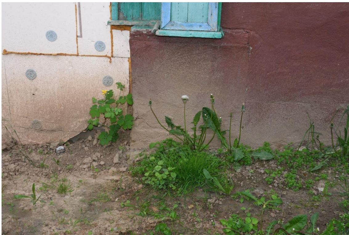
Фото 6. ОКН «Дом жилой, XIX в.». Фрагмент северного фасада. Отмостка по главному (северному) фасаду отсутствует.
