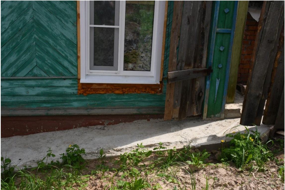
Фото 7. ОКН «Дом жилой, XIX в.». Фрагмент западного фасада. Утрачены деревянные наличники окон, отмосвка в удовлетворительном состоянии.
