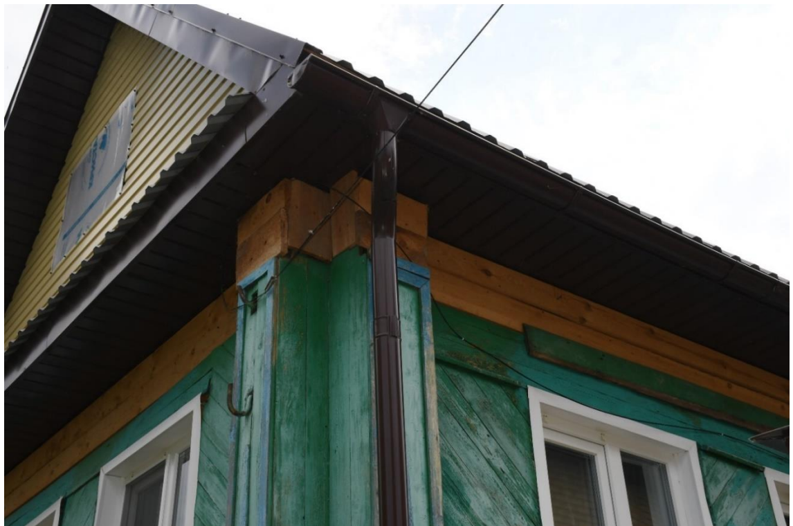
Фото 8. ОКН «Дом жилой, XIX в.». а) Фрагмент, вид с северо-запада. Без согласования Минкультуры Республики Марий Эл проведены работы по замене конструкций крыши с изменением угла наклона скатов и замене кровельного покрытия, неудовлетворительное состояние отделки фасадов, наличие утрат, отслоение окрасочного слоя, уничтожены наборные наличники окон, уничтожен венчающий карниз с фризом.
