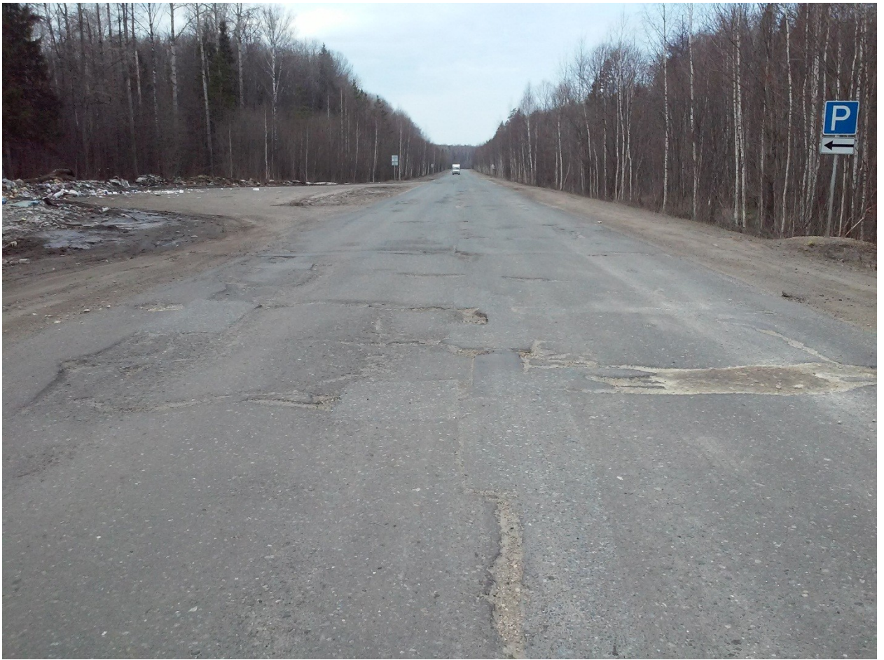
Фото 3. Автомобильная дорога Кокшайск – Красногорский на участке км 3+300 – км 5+000 (до ремонта)
