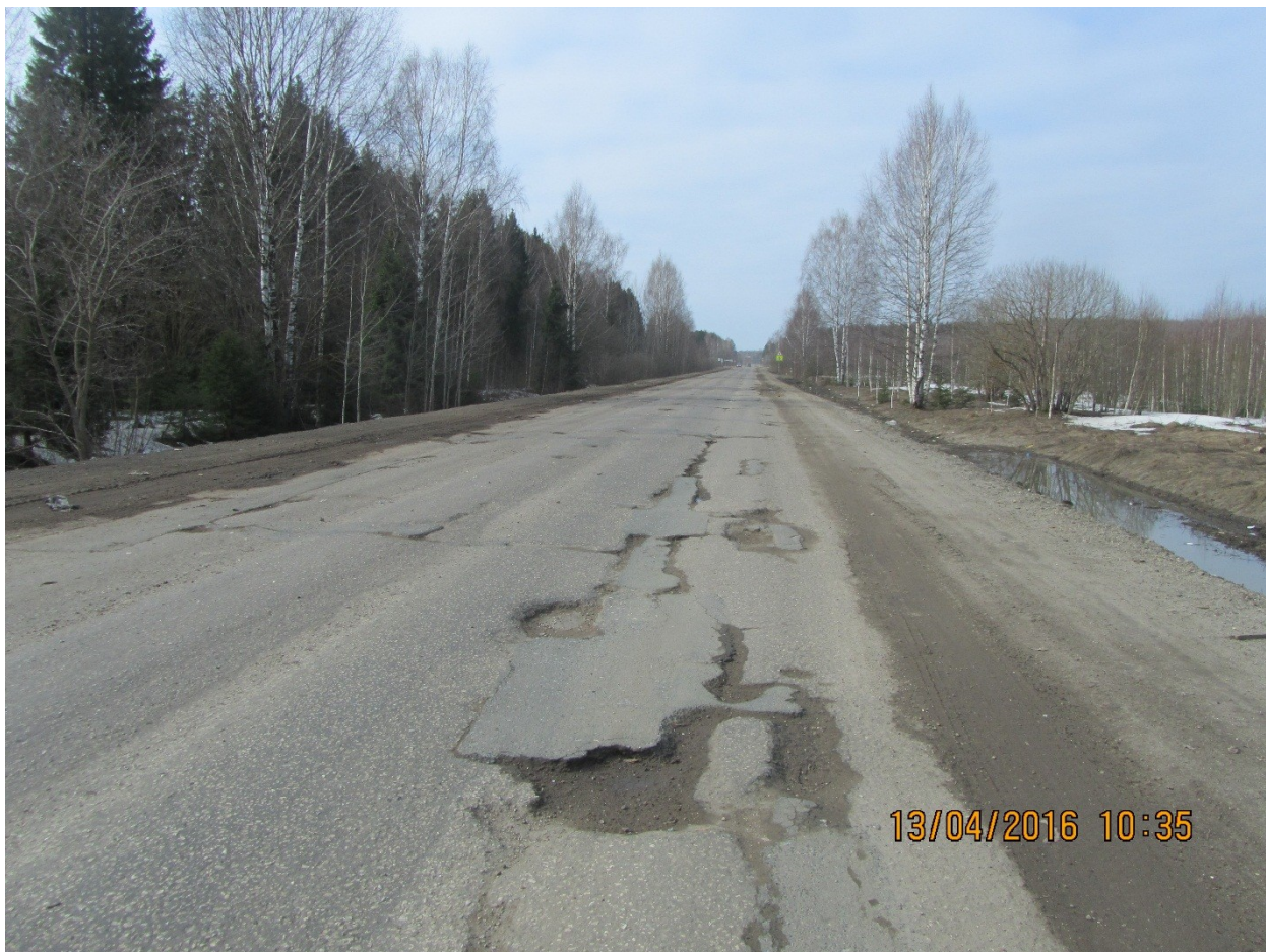
Фото 1. Автомобильная дорога Йошкар – Ола – Козьмодемьянск на участке км 21+000 – км 23+000 (до ремонта)
